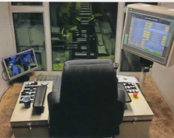
Vom Bedienstand aus wird die Anlage mithilfe von Kameras überwacht und unkompliziert gesteuert.
